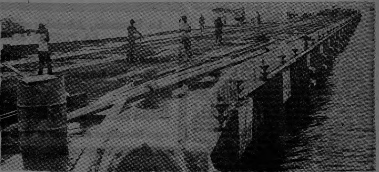
MUELLE 70. — El grabado nos muestra un aspecto general del estado actual del Muelle 70, que será inaugurado el próximo 12 de octubre. Existe gran esperanza en Limón de
